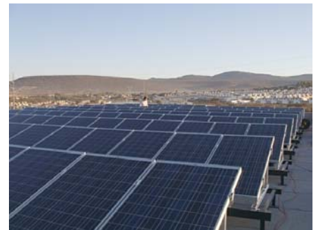
KAESER Compresores Potencia Instalada 22.23kW Módulos Solares 144
