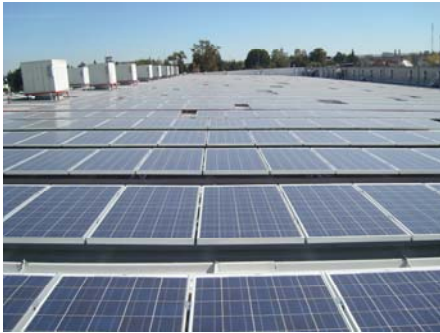
Bodega Aurrera de Aguascalientes Potencia Instalada 174kW Módulos Solares 1056
